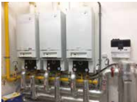
Nová plynová kotelna vytápí a zajišťuje teplou vodu také v novostavbě SBD Sever na Papírovém náměstí v ul. Na Poříčí
