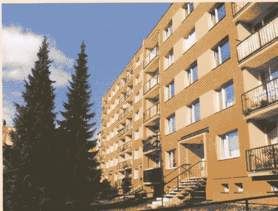
S využitím státní dotace z programu Panel na dotaci úroků z úvěru byla provedena rekonstrukce domů v lokalitě ulice Na Jezírku. Realizaci prováděla firma Syban z Liberce.
